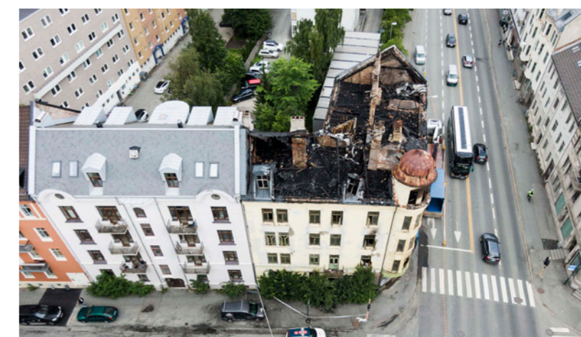
Sammen med politiets kriminalteknikere og Det lokale el-tilsyn gjennomførte TBRTs brannetterforskere undersøkelser i bygget. Det ble konkludert med at årsaken trolig var tilførsel av bar ild. (Foto: Politiet)
