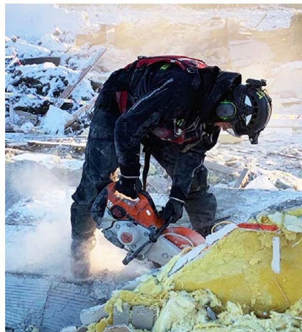
BYGNINGSMASSER: Bit for bit av bygningsmasse måtte fjernes, enten manuelt eller ved å dele opp med motorsag, bajonettsag eller betongknuser.
